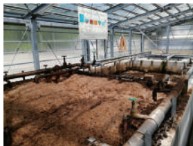
污水处理池（曝气）
